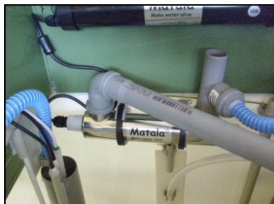
Fig. 3: Blikk på UV-lampen i renseanlegget
