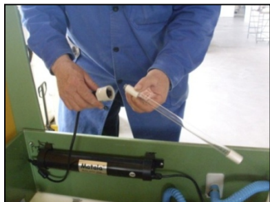
Fig. 9: Utskifting av UV-lampe
