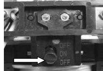
Interruptor protección del diafragma activado. (La bomba no funciona).
